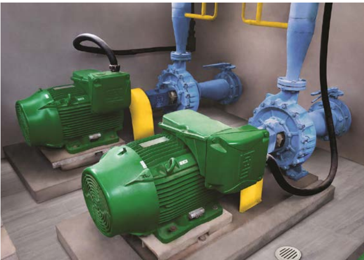
A WEG W22 IE3 motor driving a pump.
